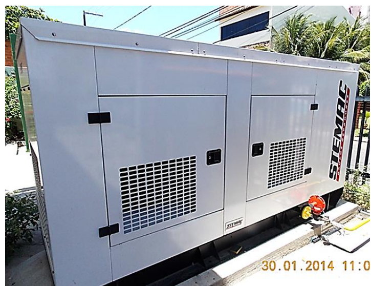
Imagem 2 - Gerador a gás do Hotel Sergipe instalado em janeiro de 2014
